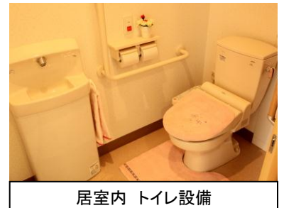
居室内 トイレ設備
